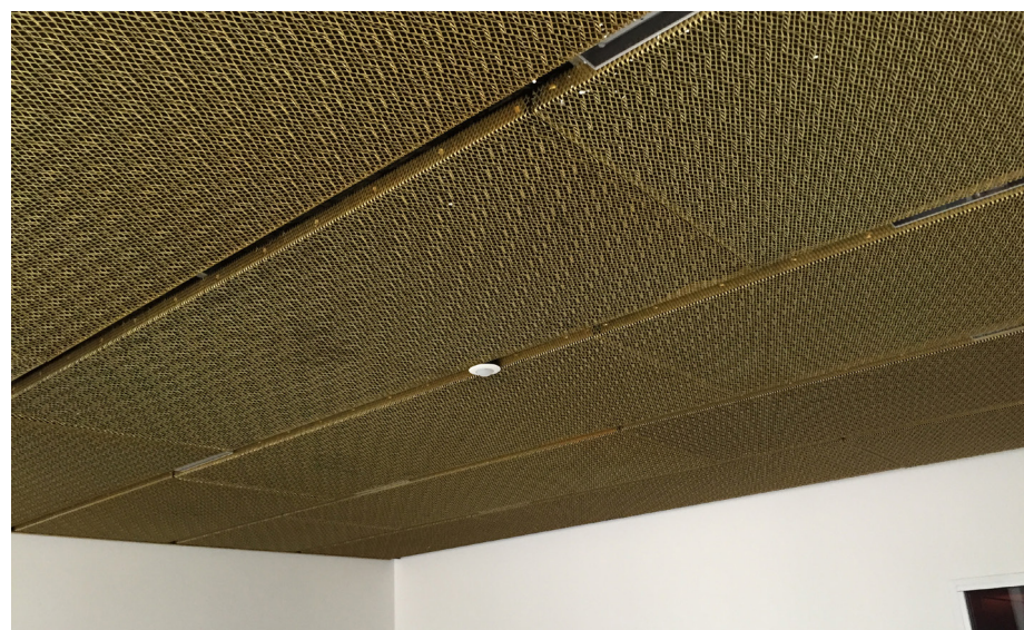
Decke Swisscom Zürich
